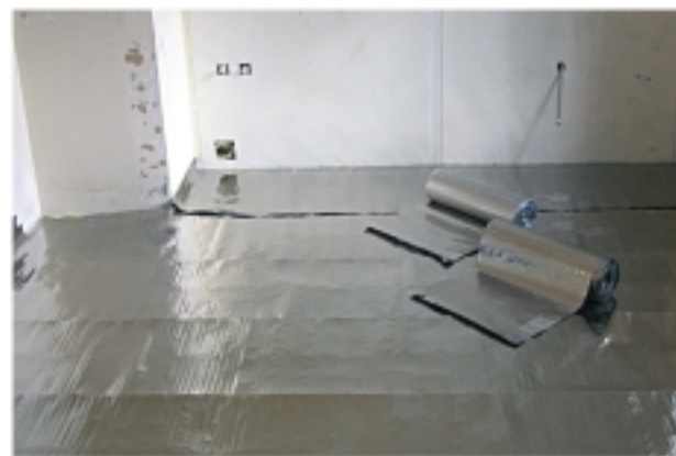
РИСУНОК 13 | Размещение рулонного экрана на полу помещения для экранирования магнитного поля силовой подстанции.
