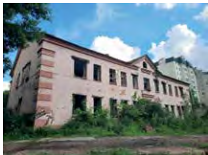
Рис. 3. Аварийный дом, по ул. Никитинская, г. Воронеж. Фото А.Э. Заплавной, 2021 г.
