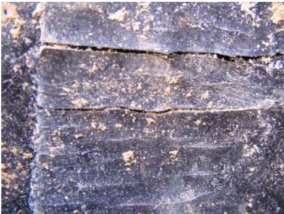
Рисунок 8. Охрупчивание и растрескивание изоляционного покрытия
