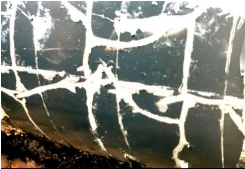
Рисунок 7. Поверхность трубы после снятия изоляционной пленки (тёмные участки – праймер на поверхности металла; светлые полосы – зоны контакта металла с грунтовой водой)
