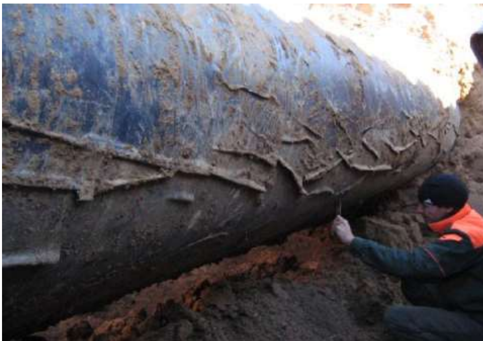
Рисунок 6. Гофры на изоляционном покрытии
