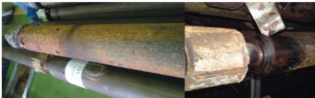
Рисунок 3.2.3 – Коррозия корпуса насоса
